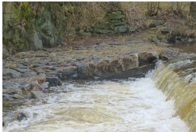
pohled z LB, destruovaný skluz
