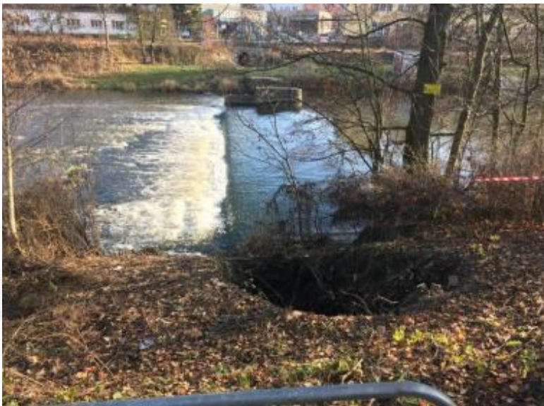
pohled z LB (propad kanalizace – zasypáno 2020)
